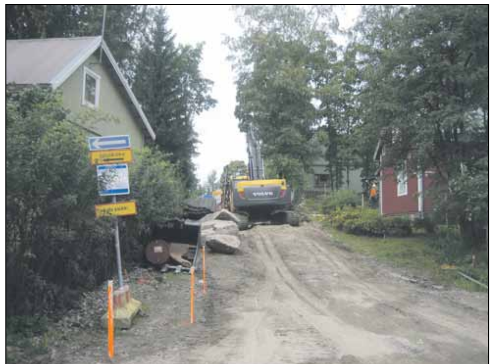
Katurakentaminen on ollut vilkasta. Heinälammelle on tehty kolmelle alueelle aivan uusia katuja. Hols-tissa on uusittu katujen putket ja johdot sekä ne ovat saaneet uudet pinnoitteet (kuva holstista).
